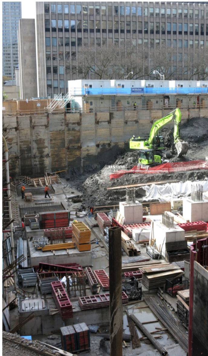
Mise à jour sur le nouveau Palais de justice de Toronto Printemps/été 2019
