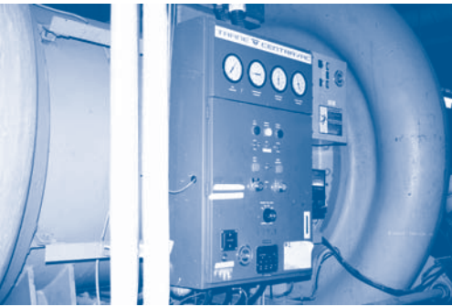
Dispositif de commande d'un refroidisseur, au Complexe de Queen's Park
